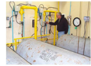
Chlorine Ton Cylinder (gas)
